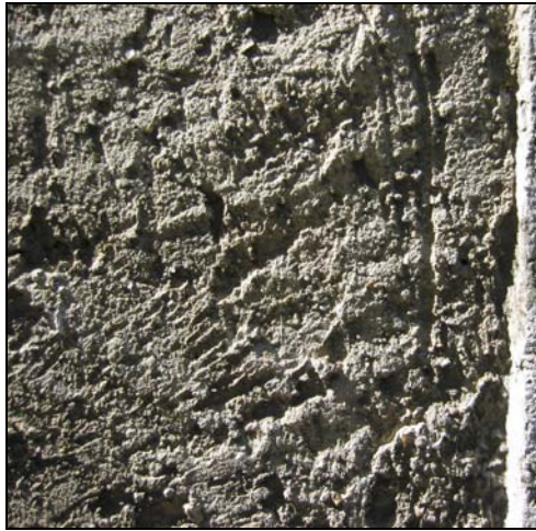
Enduit à la chaux jeté recoupé, usé
