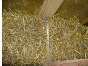
Figure 2.2 : Feuillard métallique entre deux montants
